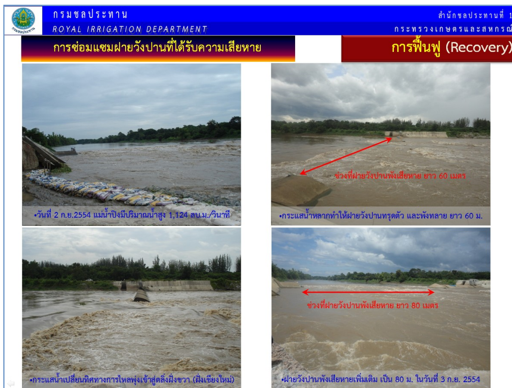
รูปที่ 39 โครงการซ่อมแซมฝายวังปานที่ได้รับความเสียหาย
