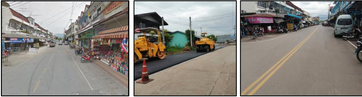
ปรับปรุงถนนลาดยางผิวทางแอสฟัลติกคอนกรีต บริเวณถนนรอบเวียงด้านทิศใต้ถึงแยกหัวเวียง บ้านแจ่งกู๋เรือง หมู่ที่ ๔ ตำบลเวียง อำเภอพร้าว จังหวัดเชียงใหม่ หนา ๐.๐๕ เมตร มีพื้นที่ไม่น้อยกว่า ๗,๑๕๐ ตารางเมตร งบประมาณ ๑,๘๐๐,๐๐๐ บาท
